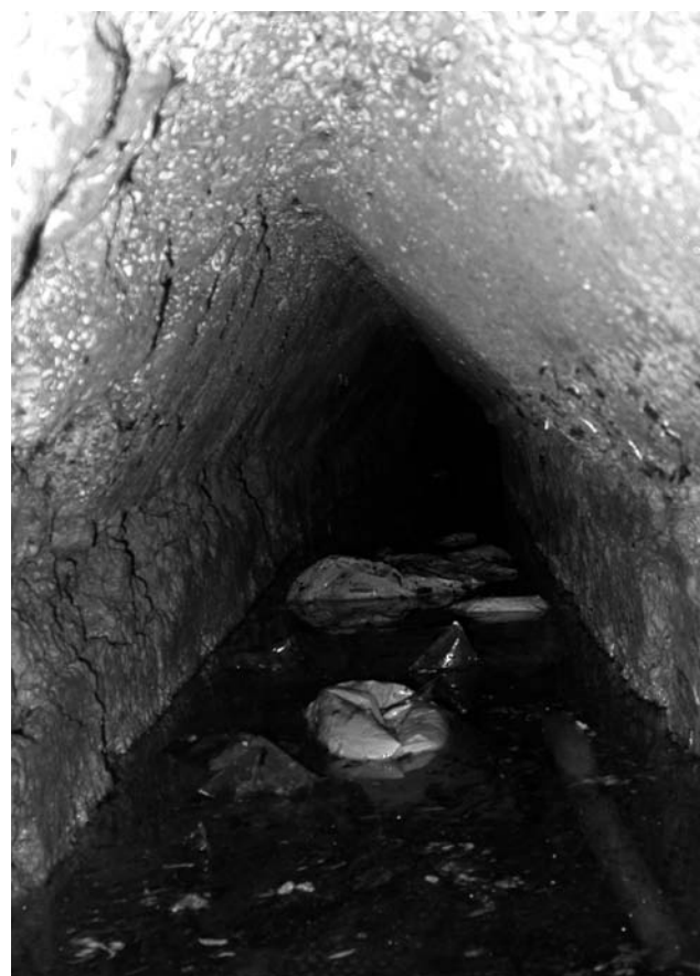
10. Un tratto dell'acquedotto romano completamente allagato.
